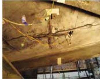
Распределение трещин в нижней части плиты
